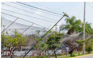
El alambrado de unas canchas de fútbol ubicadas sobre Calzada Independencia Norte y Volcán Irazú, se cayó parcialmente.
