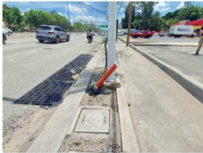
■ Hay pendientes en camellón central y jardineras de ciclovía. Aún están expuestas algunas mangueras para soterrar cableado.
