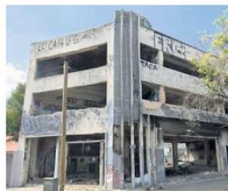
ABANDONO. Diversos edificios de carácter notable han sufrido falta de mantenimiento.
