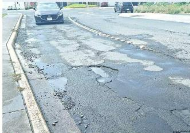
Las lluvias han acelerado los problemas de baches en la Av. Magallanes, en el exterior del fraccionamiento Loreto.
