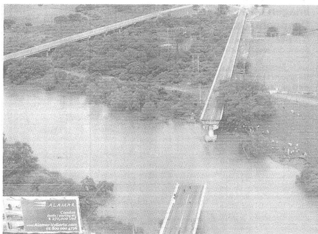
VISTA AÉREA del puente colapsado sobre el río Ameca en los límites entre Jalisco y Nayarit.
