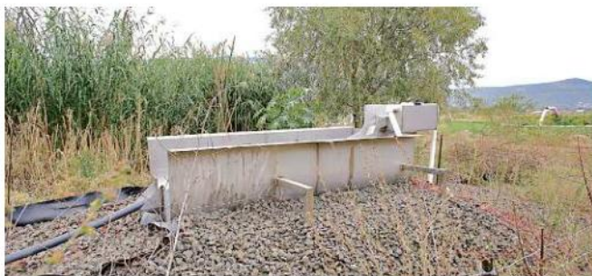
Dos de los humedales que filtran el agua hacia la laguna permanecen sin funcionar.
