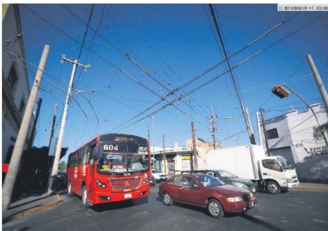
ABANDONO. En Belisario Domínguez se puede observar la infraestructura que ya no es usada por el Trolebús.
