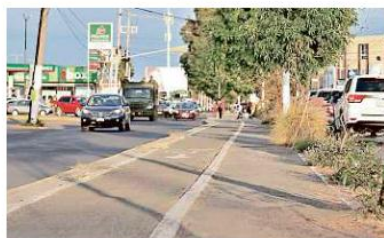
■ A la altura de Avenida del Servidor Público, en Zapopan, la pista ciclista de Santa Margarita tiene desgaste.
