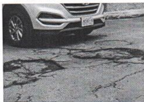
UTILIDAD: Los ciudadanos pueden reportar daños en el pavimento y fallas en servicios como movilidad y alumbrado.
