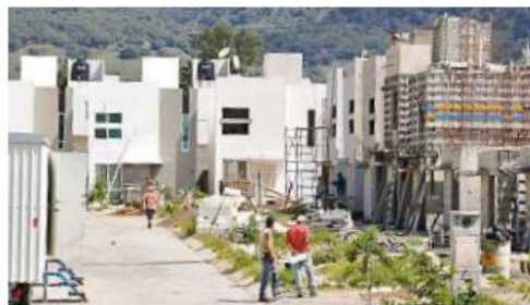
■ La construcción de la segunda etapa del fraccionamiento está en marcha, lo que ha causado agrietamientos en casas.
