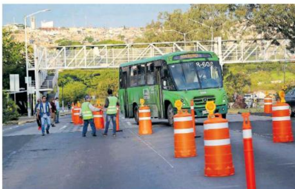
Las obras comienzan con la renovación de la carpeta asfáltica. FRAN-CISCO RODRIGUEZ.
