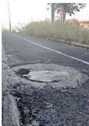
También en varios puntos existen baches o la superficie es irregular.
