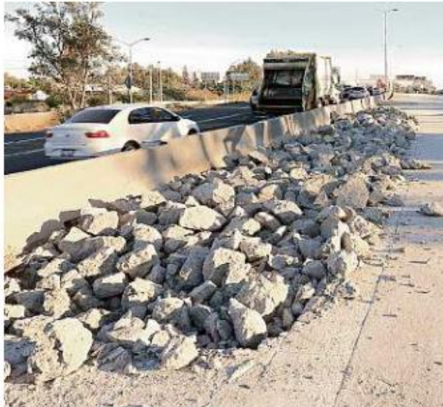
■ Por deficiencias tuvieron que destruir cerca de 100 metros de concreto ya colocado en Periférico Poniente.
