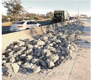
Por deficiencias tuvieron que destruir cerca de 100 metros de concreto ya colocado en Periferico Poniente.
