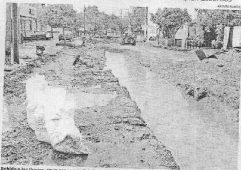
Debido a las lluvias, en la zona se registró una inundación y los trabajos se detuvieron
