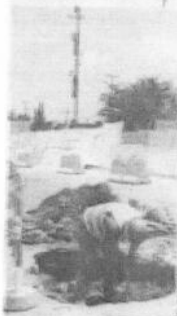
POR TERMINAR. El socavón afecta más el flujo vehicular en la avenida Federalismo.
