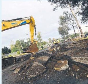
NOVEDAD. El Peribús (llamado MI Macro Periférico), otra de las obras insignia.
