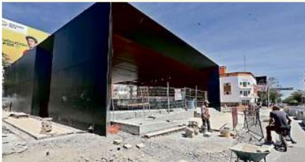
■ En la estación de Avenida Revolución y Calzada Independencia se observa trabajo de maquinaria.
