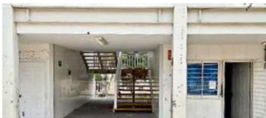
■ En el edificio hay grietas en muros, techos y hasta banqueta.
