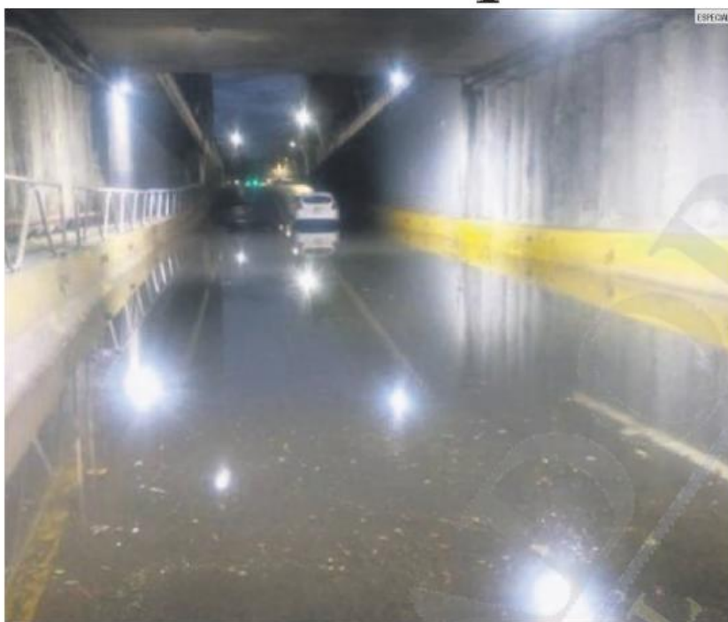
AVENIDA HIDALGO. El túnel se inundó hasta 40 centímetros; Protección Civil atendió la emergencia.
