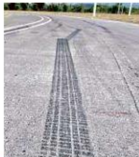
En la zona del incidente permanecen las huellas de frenado de esta actividad.
