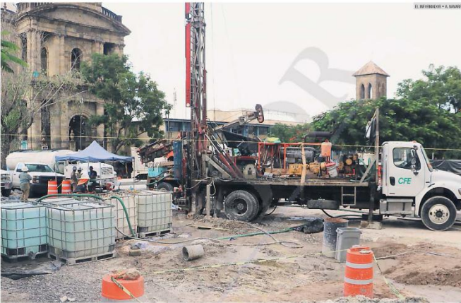
AFECTACIONES. Tras las obras del túnel de la Línea 3, edificios históricos resultaron dañados.
