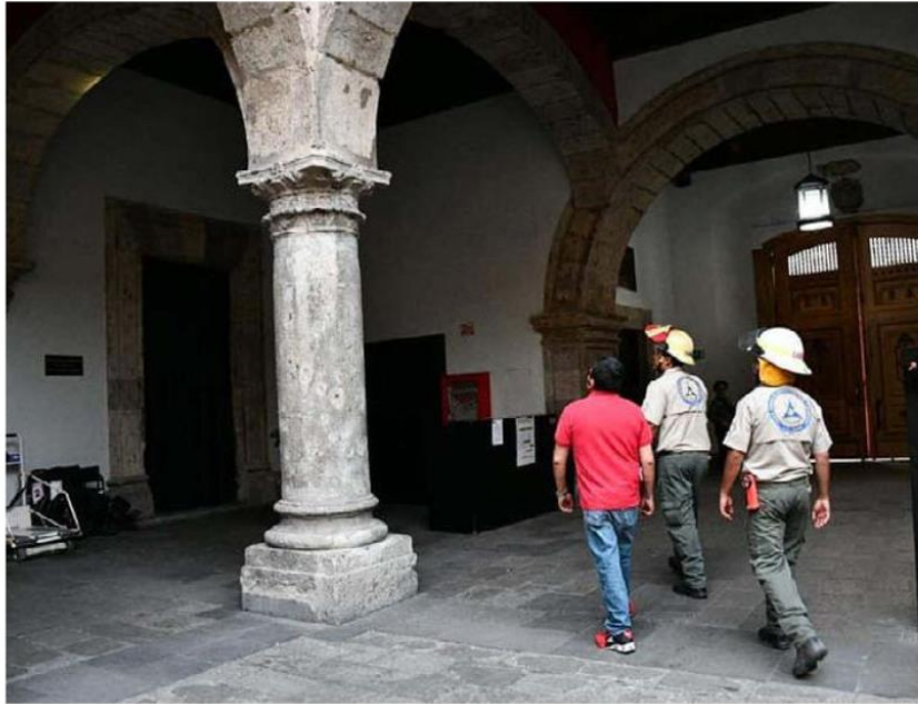
Personal de Protección Civil revisa la estructura del Palacio de Gobierno. ESPECIAL
