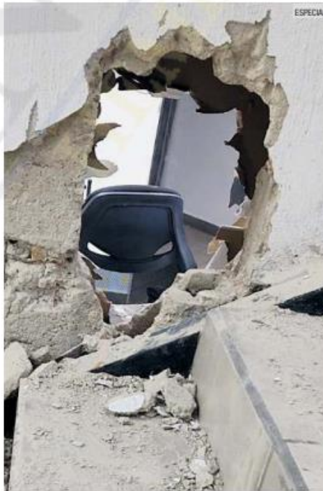
DAÑOS. Así quedó la pared del negocio siniestrado.
