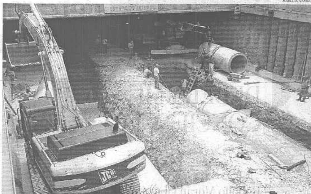
La Contraloría no puede avanzar en la investigación de la fractura del colector de Las Rosas por el retraso de Sedeur
