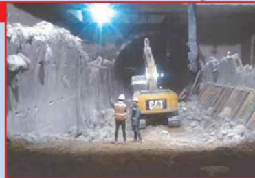
DAÑO DE $800 MILLONES. Un cambio en el plan de trabajo del túnel de la Línea 3 implicó la destrucción de dovelas ya instaladas.
