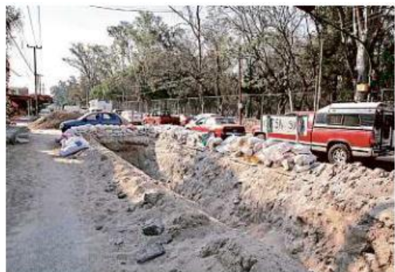
■ Ante la falta de movimiento, quedó una zanja sobre la Calle Medrano, entre Avenida San Jacinto y Manuel Portillo.
