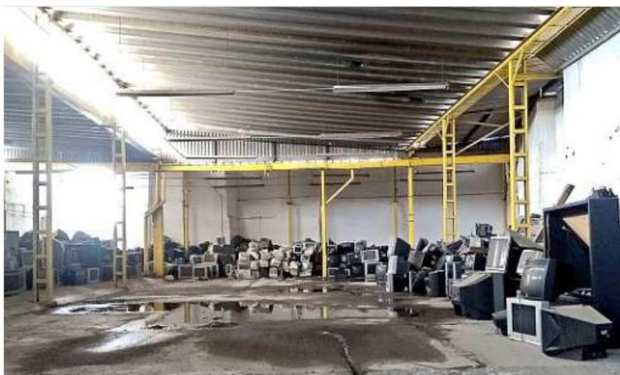
■ En una bodega rentada por la Semadet hay 3 mil 500 televisores analógicos arrumbados que no se pueden mover ni darles destino final. Ahí entra lluvia que se podría mezclar con químicos.
