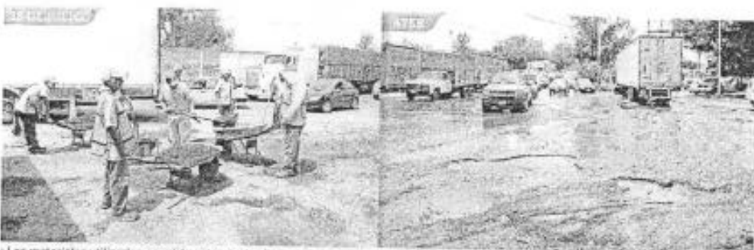
Los materiales utilizados por el Ayuntamiento de Guadalajara para bachear no soportaron la lluvia del lunes ni el paso de los vehículos.
