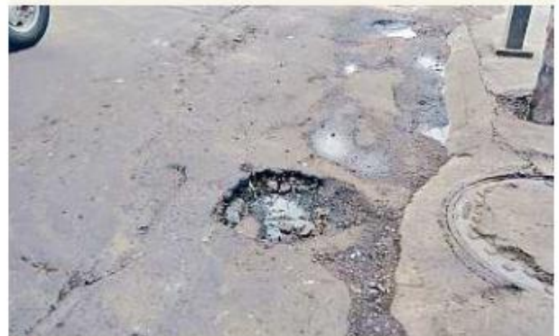
Los baches que se encuentran en este punto se niegan a "morir" y provocan daños en los vehículos.
