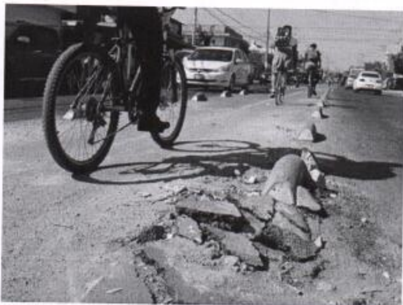
Detriorada. Así luce la ciclovía de Santa Margarita.
