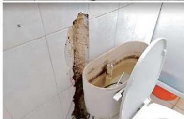
En varias áreas del hospital hay bancas incompletas, y en algunos baños no hay papel higiénico ni jabón y faltan hasta las tapas de varios sanitarios.
