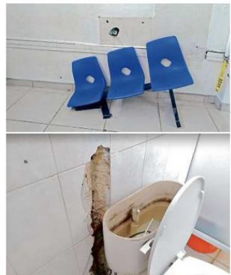
En varias áreas del hospital hay bancas incompletas, y en algunos baños no hay papel higiénico ni jabón y faltan hasta las tapas de varios sanitarios.
