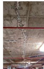
Algunos muros de Ciudad Judicial tienen humedad, al igual que el techo del estacionamiento subterráneo.
