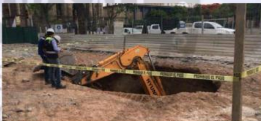
El hundimiento del pasado 6 de mayo podría replicarse a lo largo del trazo de la Línea 3, poniendo en riesgo edificaciones emblemáticas de la capital.
