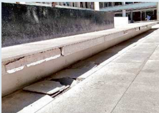
■ En el patio central de Ciudad Judicial se puede apreciar el desnivel del piso, así como el deterioro de áreas comunes.
