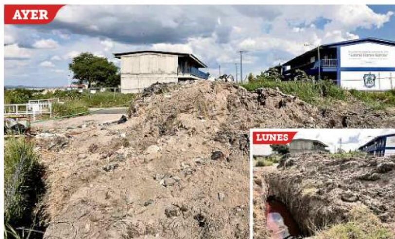
■ Ayer a mediodía fue tapada la fosa que construyó PEMEX para captar combustible que se fugaba por una toma clandestina; estaba a 20 metros de una secundaria, en Colinas del Roble.
