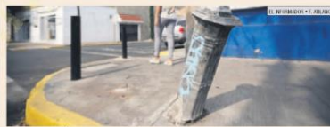
RAMOS MILLÁN. Así lucen muchos de los dispositivos instalados en la ciudad.
