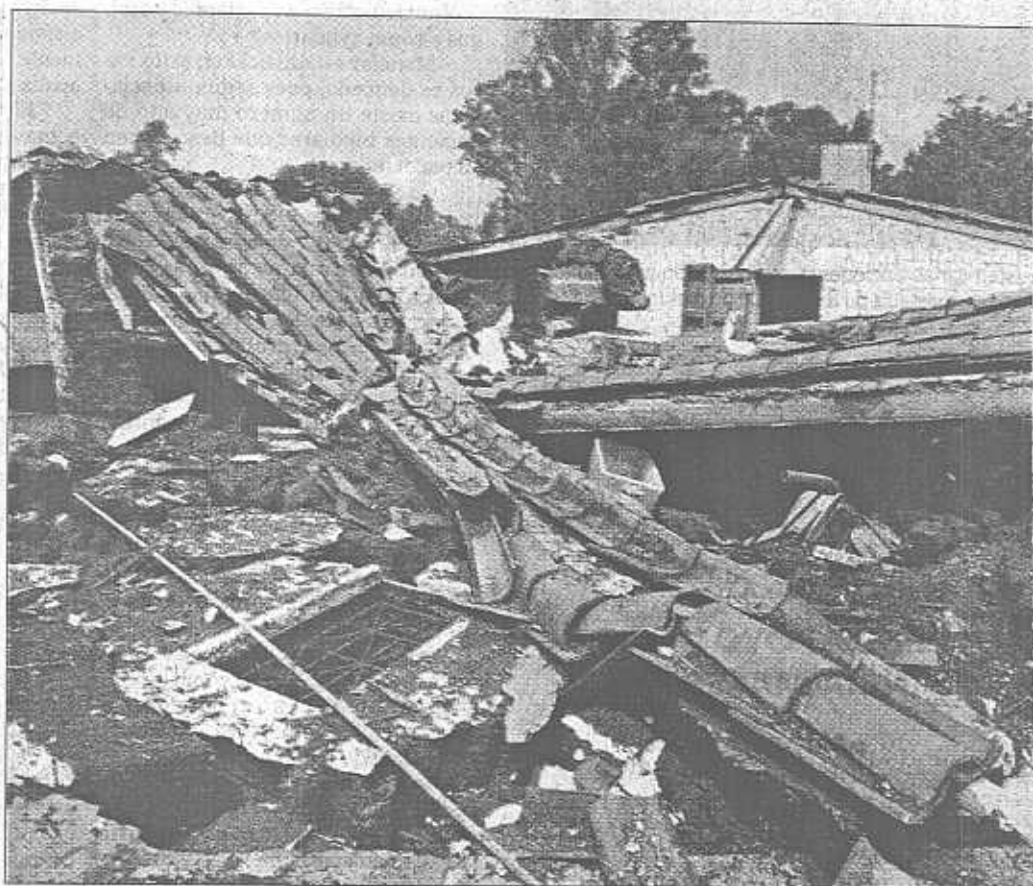
• Así quedó esta vivienda tras las lluvias registradas durante la semana en la colonia La Lagunita.
