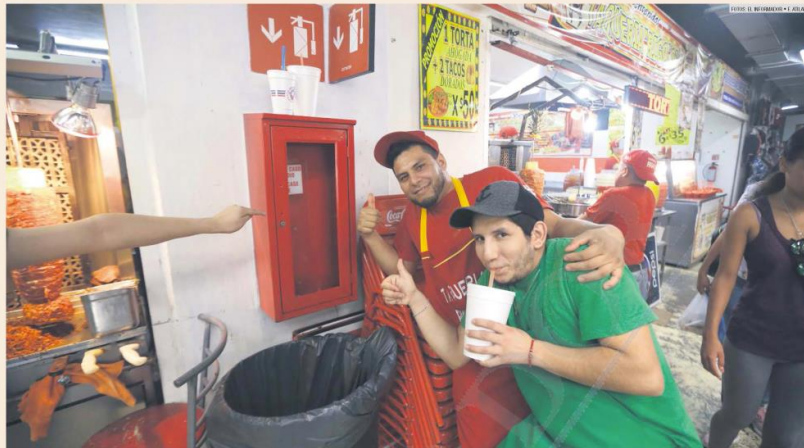
¿CUAL RIESGO? Trabajadores del Mercado Corona posan para reeducar que el espacio en donde debería haber un extinguidor es sólo un soporte para visos. El riesgo de incendio en el interior de un mercado siempre existe, y de ser necesarios, no hay equipos que puedan ayudar a sofocarlos antes de que se extiendan las llamas.
