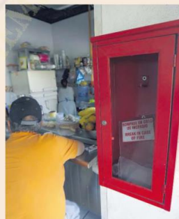
RÓMPASE Y FINJA QUE SIRVE. Si se presenta una emergencia, romper el vidrio sólo servirá para obtener un letrero.
