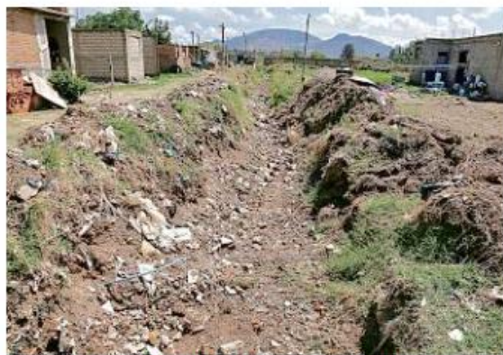
■ Los ladrilleros de la zona han excavado las canaletas para extraer, de forma irregular, material para su producto.
