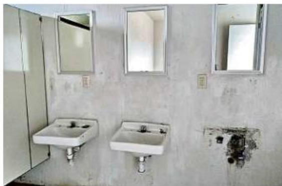
■ Y en el único abierto, uno de los lavamanos fue arrancado, además de que hay olor a orines y suciedad en retretes.
