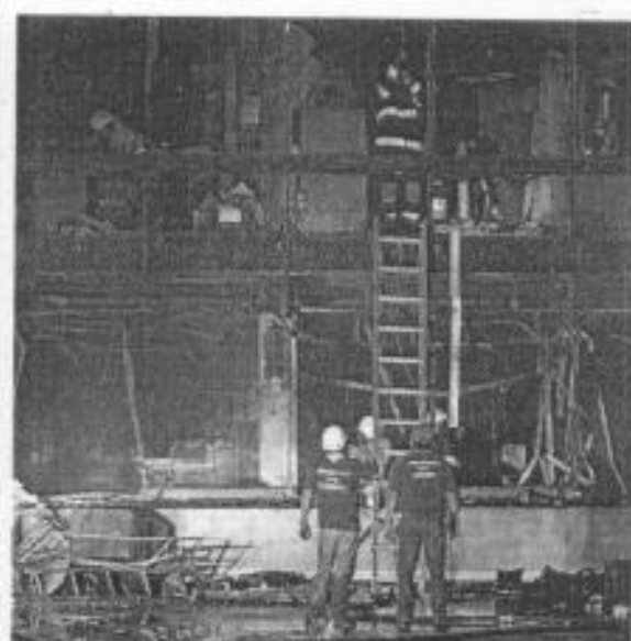
Severos daños sufrieron los edificios del Palacio de Gobierno.
