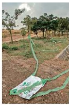
Tlajomulco clausuró la obra porque la GN taló árboles sin permiso. Además no solicitó licencia para hacer la obra.
