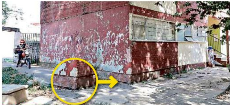
EN RIESGO... Uno de los nueve edificios de la Unidad Valentín Gómez Farías ha comenzado a exhibir sus cimientos, ante el hundimiento del terreno.
