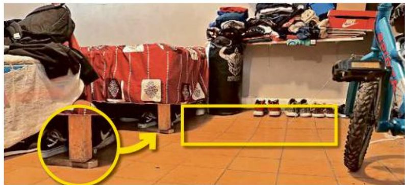
SE HUNDE... Los pisos han comenzado a pandearse, ante el surgimiento de socavones.
