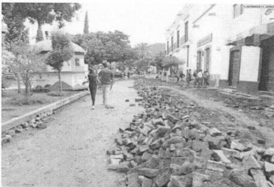
URGENCIA. Vecinos de la zona esperan que la Zona 30 se termine antes de las lluvias, pues por el momento es muy difícil la circulación peatonal.
