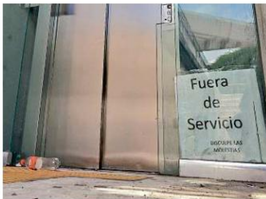
■ Ascensores en Juárez, Plaza Universidad y San Juan de Dios (foto) no sirven; esta semana quedarían reparados.
