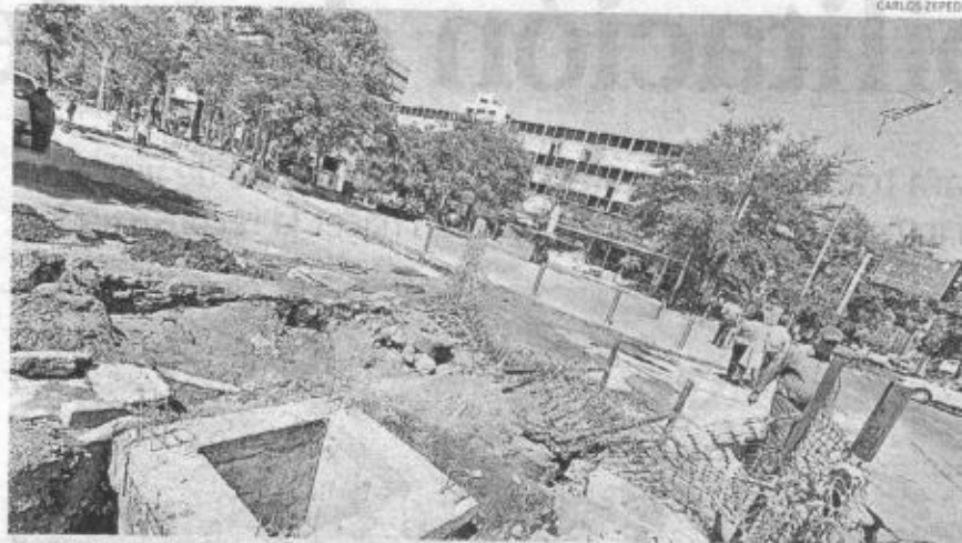
Los trabajos pendientes se aprecian en muchas banquetas de la avenida
