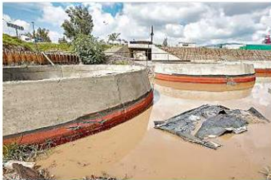
■ Ayer, los respiraderos del túnel que ya se construyó en Periférico tenían agua acumulada a su alrededor.
