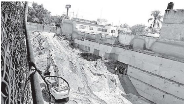
Las fincas aledañas están dañadas por la profundidad de las excavaciones
