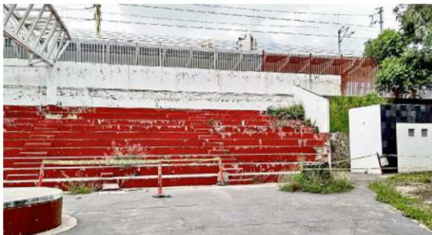
■ Las gradas del parque lucen con pintura suelta; además hay hierba crecida y señales que limitan el paso en varias zonas del área verde de Guadalajara.
