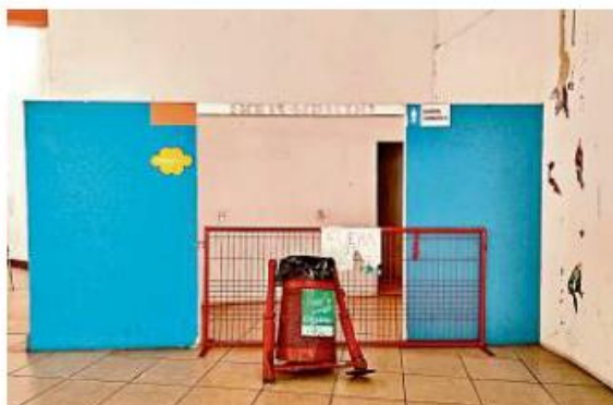
■ El parque tiene tres módulos de baños, pero sólo uno está abierto. El resto permanece bloqueados.
