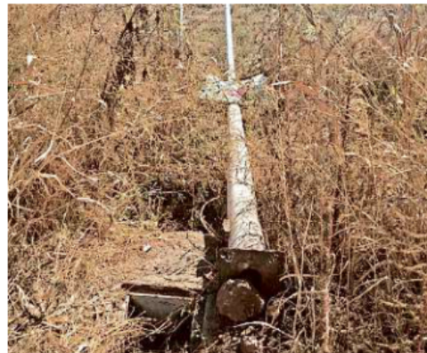
Los postes de luz saqueados terminan tirados, sin cables.
