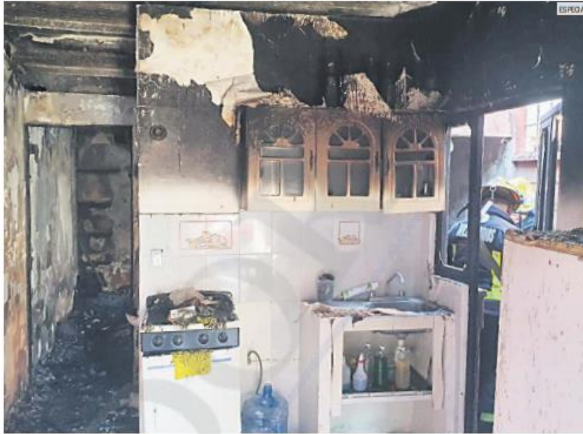
SUPERVISIÓN. Las autoridades revisaron la finca para descartar daños estructurales.
