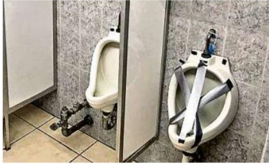
■ En este estado se encuentran los baños del edificio del Congreso del Estado, ubicado en la Avenida Juárez.
