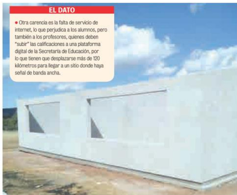
INCONCLUSAS. Estas aulas no tienen ni techo para que los alumnos puedan tomar sus clases
