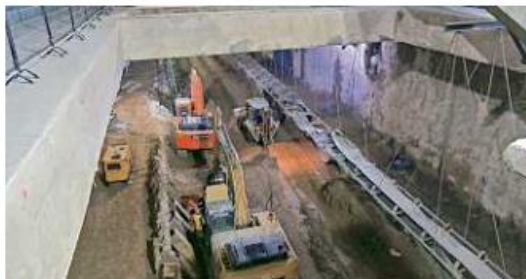
■ Dentro de las obras de la La Normal es visible la humedad que permea en las paredes y techos de lo que será la estación.
