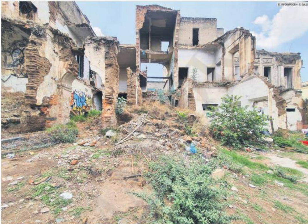
REGISTRO. En Guadalajara hay 910 fincas en estado ruinoso, principalmente en el Centro.
