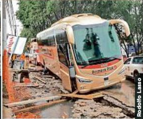
■ Un autobús cayó en el socavón de las obras de Mariano Otero.
