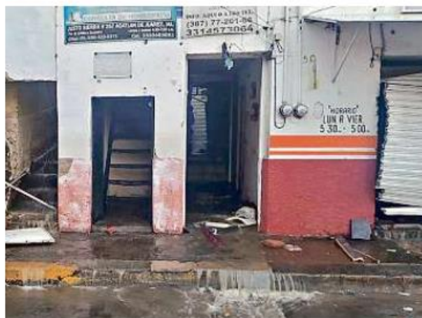
■ La pared de una casa se cayó por la corriente.
