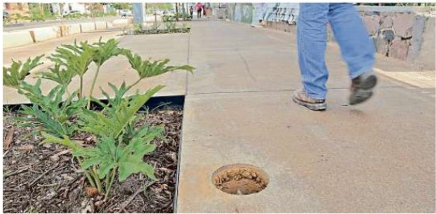
■ El tramo de 600 metros ubicado entre La Glorieta de La Normal y la Calle Jesús García tiene diversos desperfectos, como la falta de luces LED.
